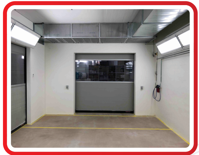
Zuluftfilterkanal UK Decke „vis a vis“ der Absaugwand
