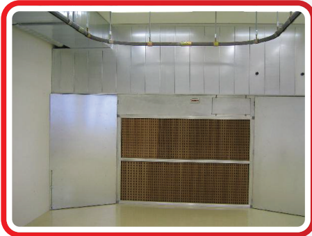
Spritzraum mit Hängebahn
